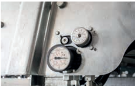
Régulation mécanique de la poussée via un potentiomètre mécanique
