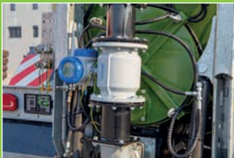
Strømningsmålingen under spredningen måles induktivt ved hjelp av den digitale strømningsmåleren Optiflux 2300 fra firmaet Krohne.
