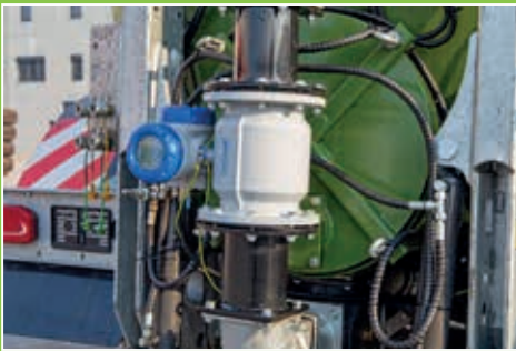
De doorstroomhoeveelheid tijdens het uitrijden wordt met de digitale doorstroommeter Optiflux 2300 van de firma Krohne inductief gemeten.
